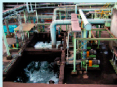
知多工場排水処理施設
