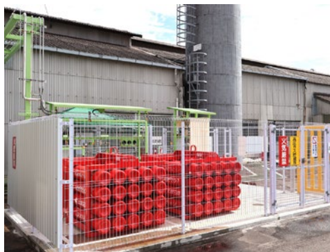
水素貯蔵設備
