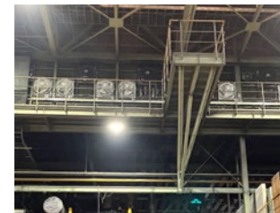
暑熱対策(建屋冷風循環)
