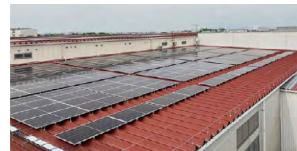
太陽光パネル(東浦工場)
