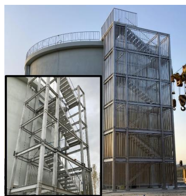
ステンレス鋼構造物エンジニアリング施工事例 配水池ステンレス製階段
