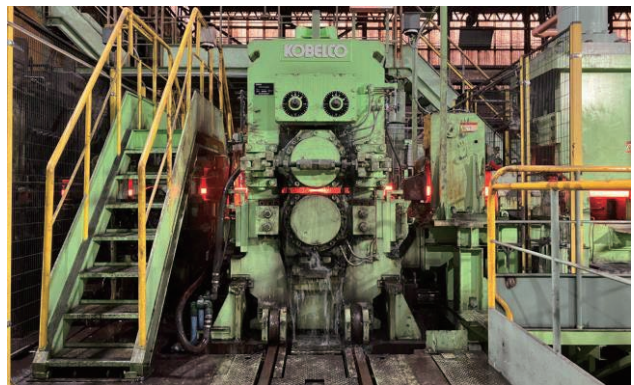
図4 今回増設したMOH圧延機
